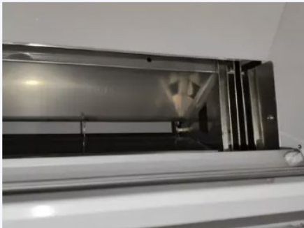
Sistema de control del polvo
