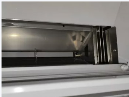
Sistema de control del polvo
